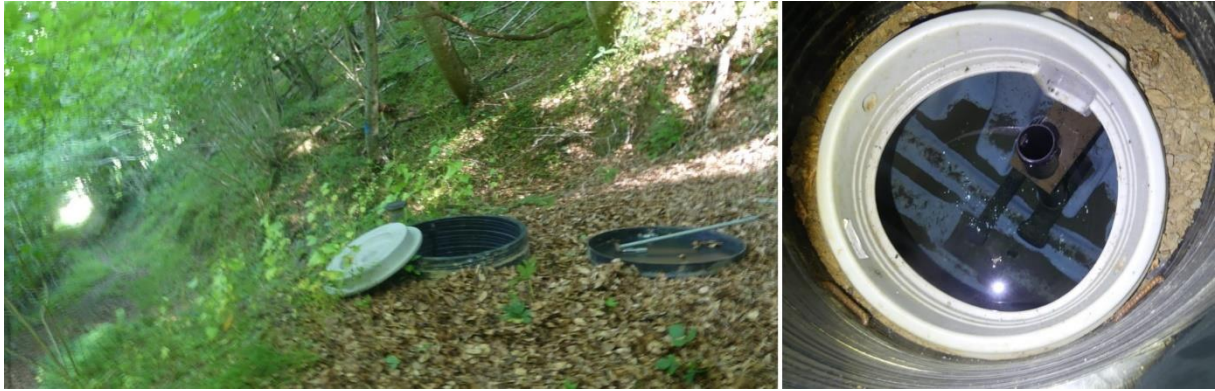
Figure 4 : Photographies du réservoir de Biac Artiguepla avec dépôt de sable en fond de cuve
